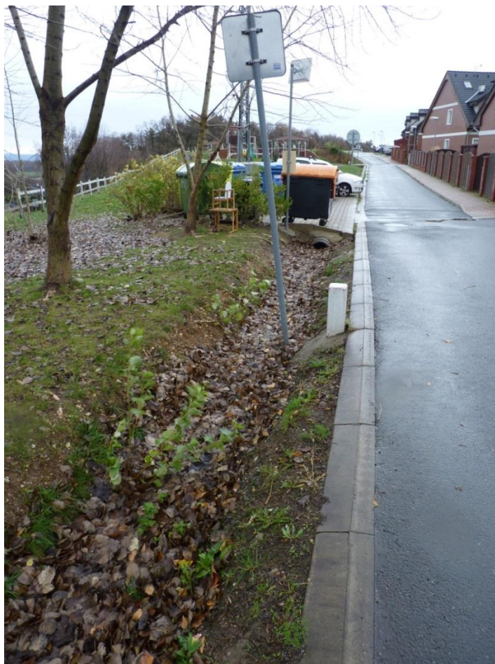
Obr. 7-2 - Dešťový příkop v areálu Anglického resortu I. V resortu je zanedbaná údržba příkopů a propustků, čímž je snížena průtočná kapacita celého systému, který pak musí být nutně náchylnější na vybřežování dešťových vod na komunikaci. Obslužné komunikace nemají krajnice. Dopravní značení je nesprávně osazené v odvodňovacím příkopu.
