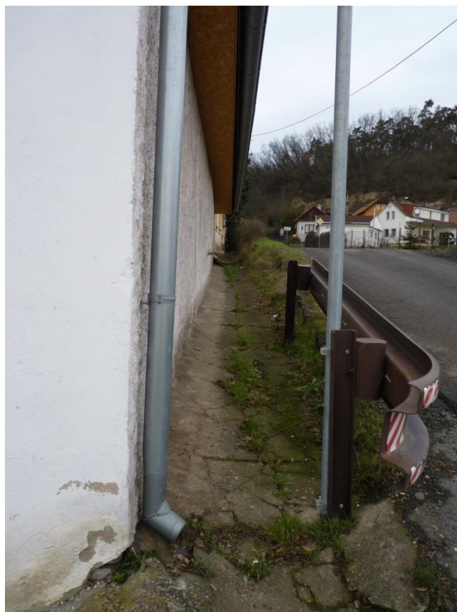
Obr. 7-36 - Současné nevyhovující odvodnění ul. Velvarská v Podhořanech
