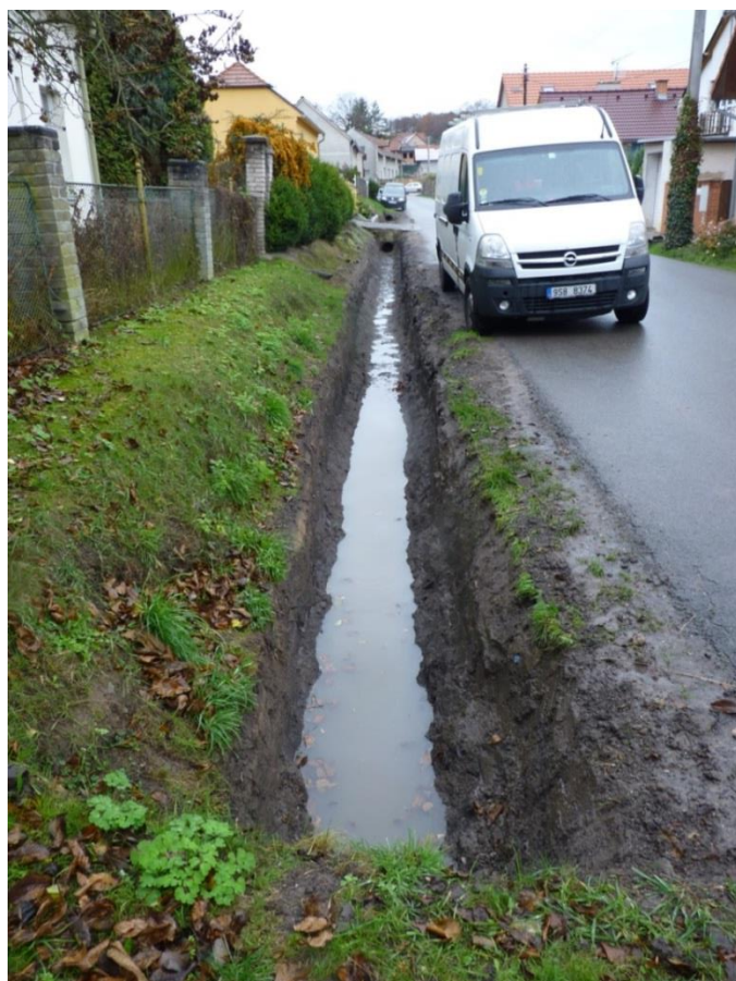
Obr. 7-9 Neodborně provedená prohrabávka jižního příkopu.
