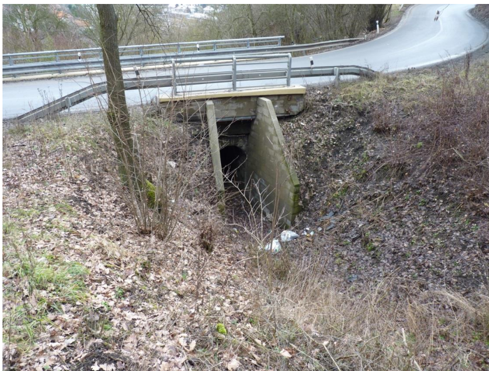
Obr. 7-38 – Kapacitní propustek pod ul. Velvarská. Za propustem však dochází k rozlivu dešťových vod do zahrad na ul. Pod Strání.
